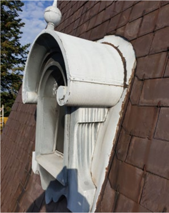
1. Bestehendes zu sanierendes Ornament
